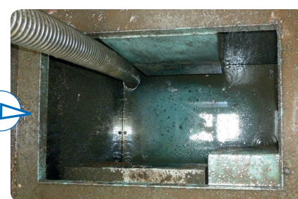
Vidange de la chambre séparateur
