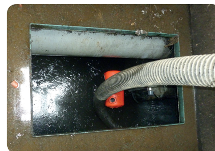
Vue de la chambre séparateur
