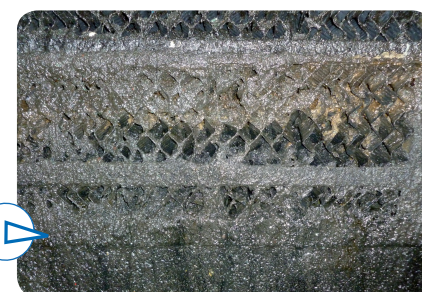
Détail d'un filtre coalescent fortement chargé en boues et nécessitant intervention
