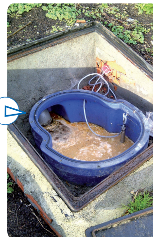
Exemple d'un séparateur de graisses devant être vidangé
